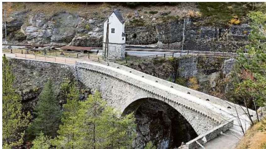
Mit einer Anerkennung bedacht: Die Verbreiterung der Jenisbergbrücke in Davos Wiesen von Conzett Bronzini Partner AG für die Gemeinde Bergün Filisur, 2020.
