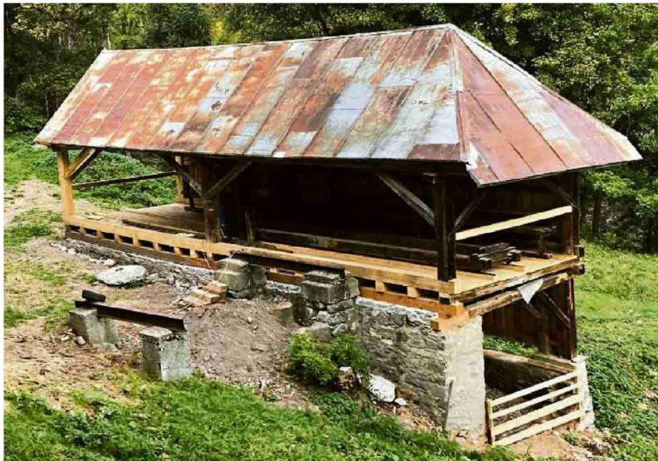
Im vergangenen Sommer fanden an der Peister Mühle Instandhaltungsarbeiten statt. Bild Verkehrsverein Peist
