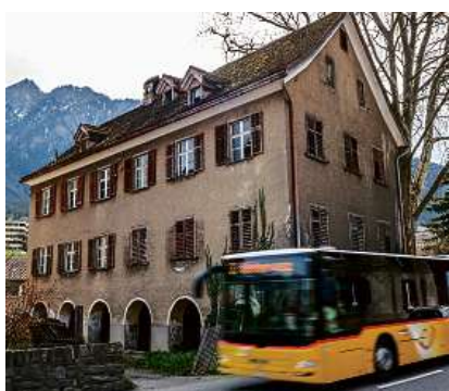
Bröckelt vor sich hin: Die Bausubstanz des Churer Hauses «zur Kante» muss laufend gesichert werden.
