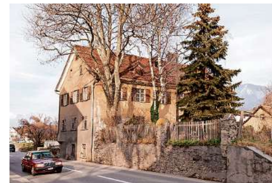
Die Bruchsteinmauer des Hauses «Zur Kante» an der Masanserstrasse bedarf einer Sanierung. (HAM)
