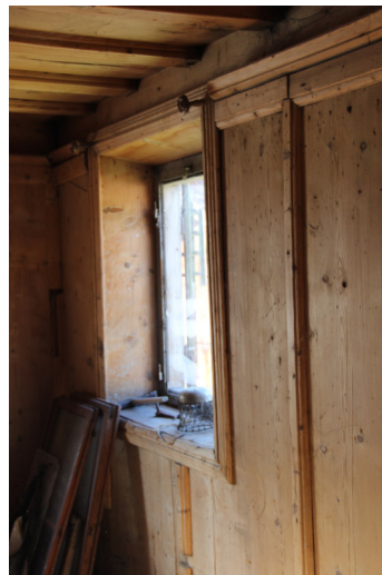
Decke als genutete Bohlenbalkendecke, an den Wänden stehendes Bretttafer mit profilierten und eingnuteten Deckleisten. Foto DPG 2021.
