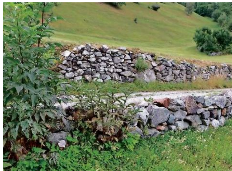
Der historische Weg, «Reichsstrasse» genannt, zerstört im vergangenen November.
