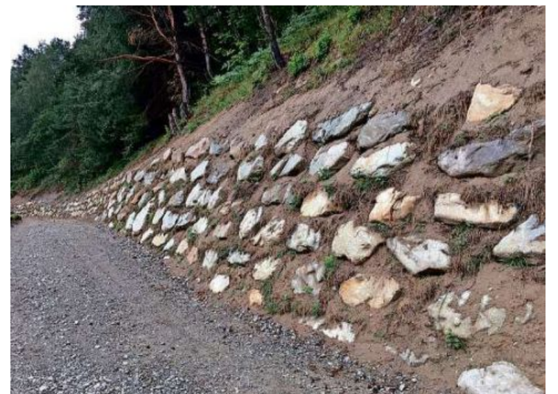
Die Rekonstruktion der kaiserlichen Strasse nach dem Gusto des Kantons Graubünden. (FOTOS ZVG)
