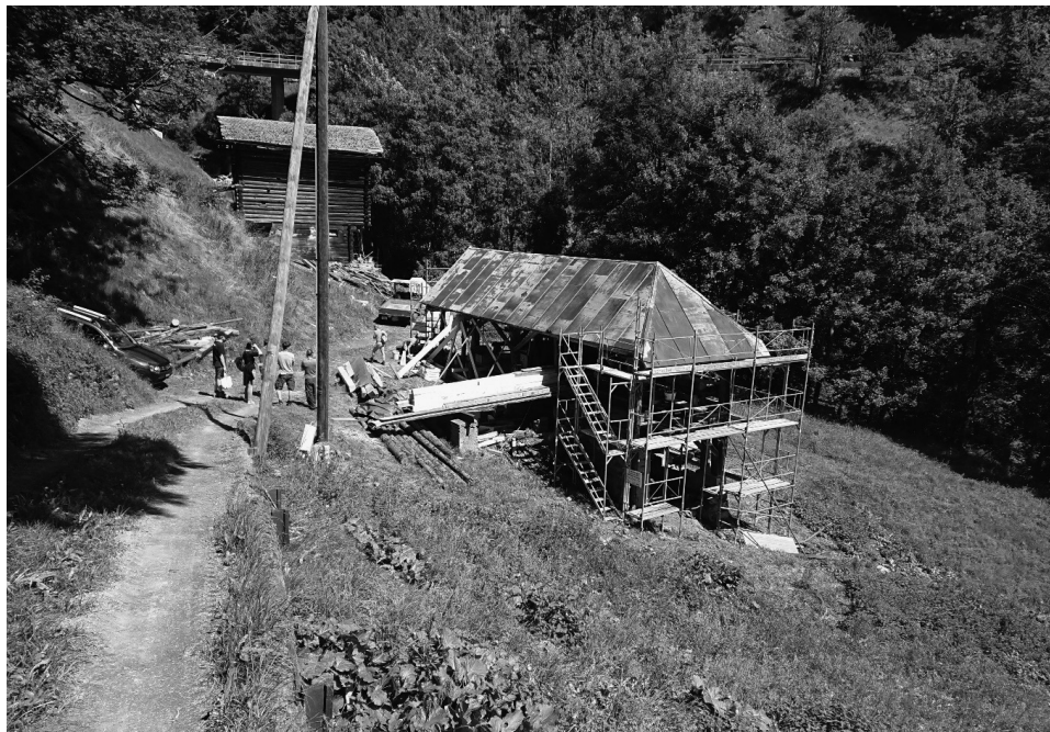
Vor dem Abbruch gerettet: Seit Sommer 2023 wird die alte Säge unterhalb von Peist im Rahmen eines Projekts der Stiftung Baustelle Denkmal unter Einsatz von Freiwilligen und Zivildienstleistenden fachgerecht restauriert.
